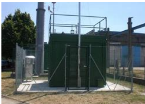
Figura 42 Centralina di monitoraggio qualità dell’aria
