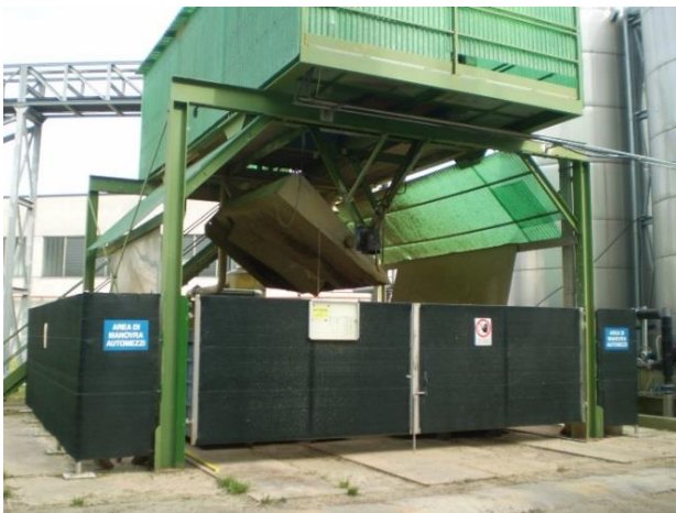
Figura 11 Particolare della filtropressa
