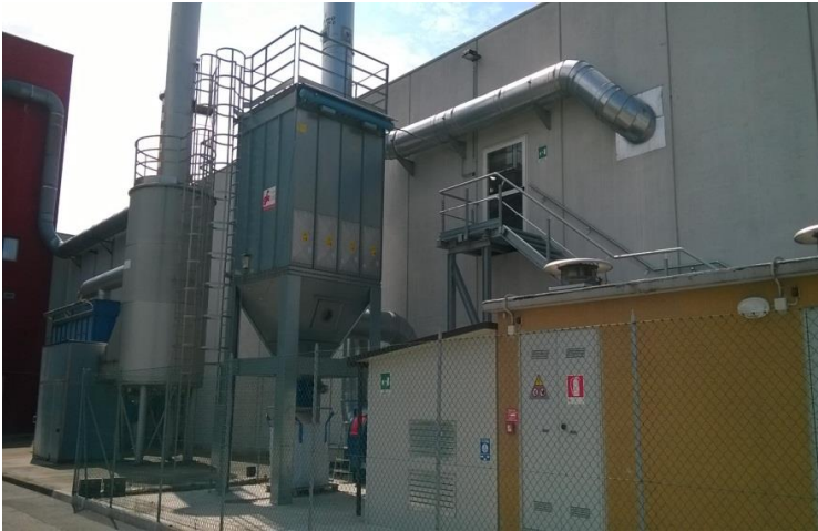
Figura 11 Particolare del filtro a maniche
