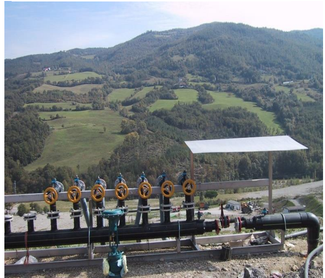
Figura 5 Impianto captazione del biogas
