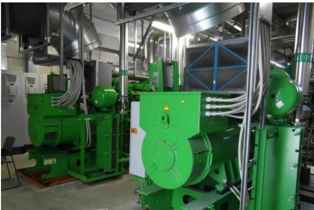
Figura 9 Gruppi di cogenerazione
