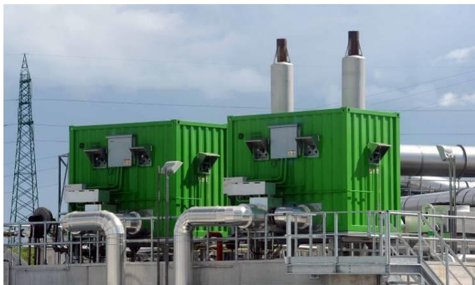
Figura 32 Punti di emissione cogeneratori (E5, E6)
