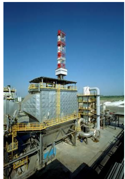
Figura 11 Sezione di depurazione fumi (F3)
