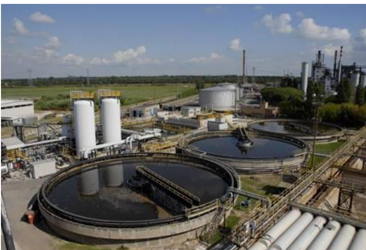
Figura 17 Vasche di sedimentazione
