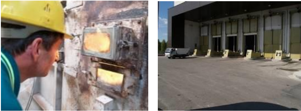
Figura 8 Finestra di controllo della camera di combustione e portoni di accesso alla fossa principale
