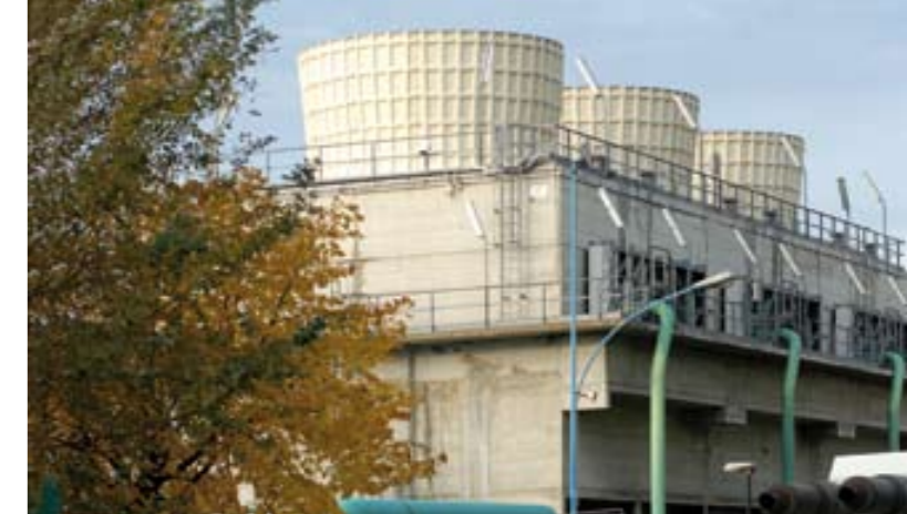
38 | Bologna, Torre evaporativa.
