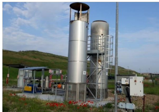
Figura 33 Torcia di combustione biogas
