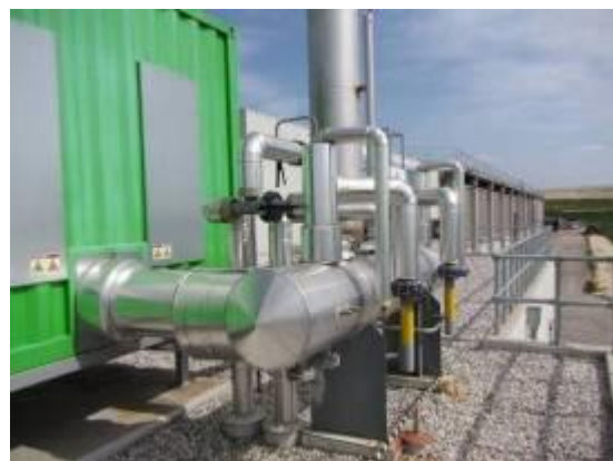
Figura 11 Sistema recupero calore dai fumi
