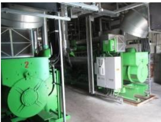
Figura 10 Gruppi di cogenerazione
