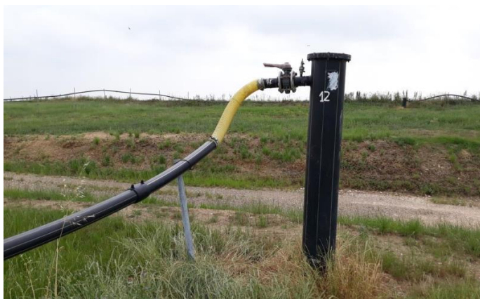
Figura 32 Pozzo di captazione biogas
