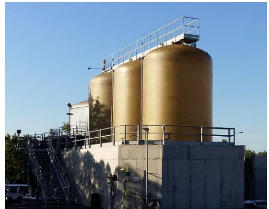
Figura 21 Sistema di accumulo presso Depuratore
