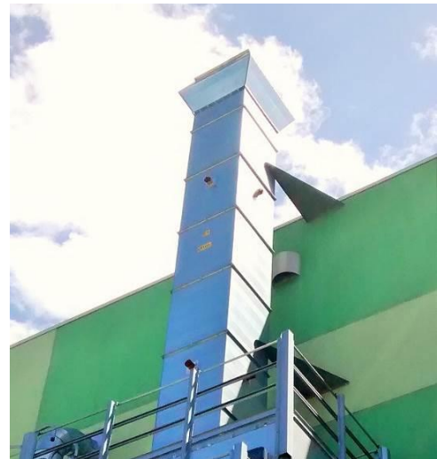
Figura 24 Punto di emissione E1
