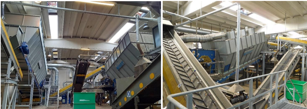
Figura 8 Particolare Linea 1: a sinistra i due separatori aeralucici e a destra i nastri trasportatori e il separatore aeralucico
