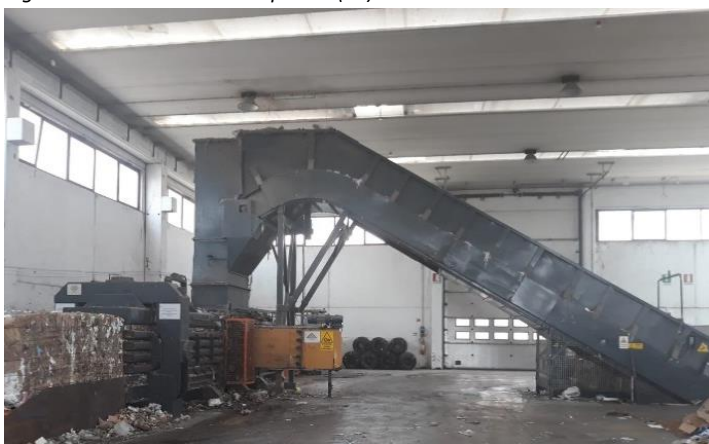
Figura 13 Particolare della pressa (L4)
