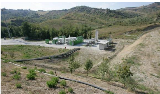
Figura 52 Impianto di recupero energetico
