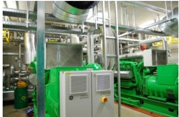
Figura 15 Gruppi di cogenerazione
