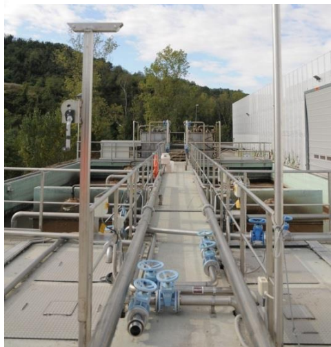
Figura 20 Depuratore biologico interno
